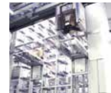
无尘室对应保管·搬运系统 - 半导体制造工厂使用的无尘搬送系统 - MCS (搬送控制·管理系统)
