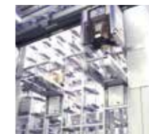
无尘室对应保管·搬运系统 - 半导体制造工厂使用的无尘搬运系统 - MCS(搬送控制·管理系统)
